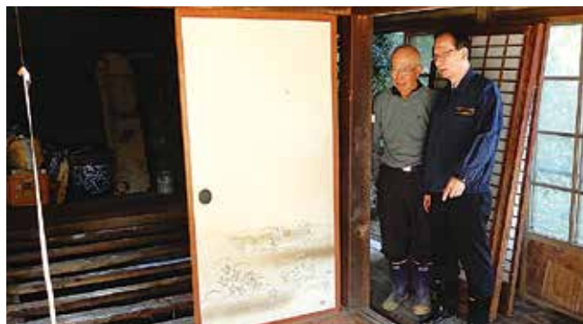
被災した住宅を訪問し、被害状況を伺う(いわき市) 11月2日
